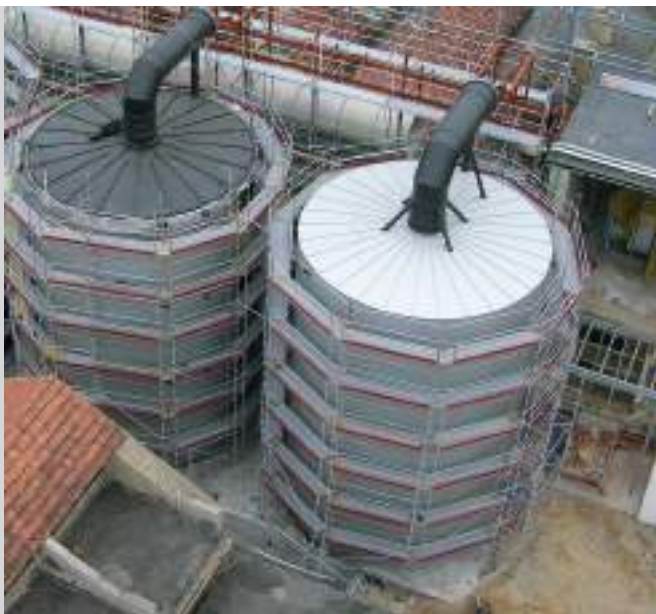
Система очистки воздуха, Испания. Материал: HD-PE
